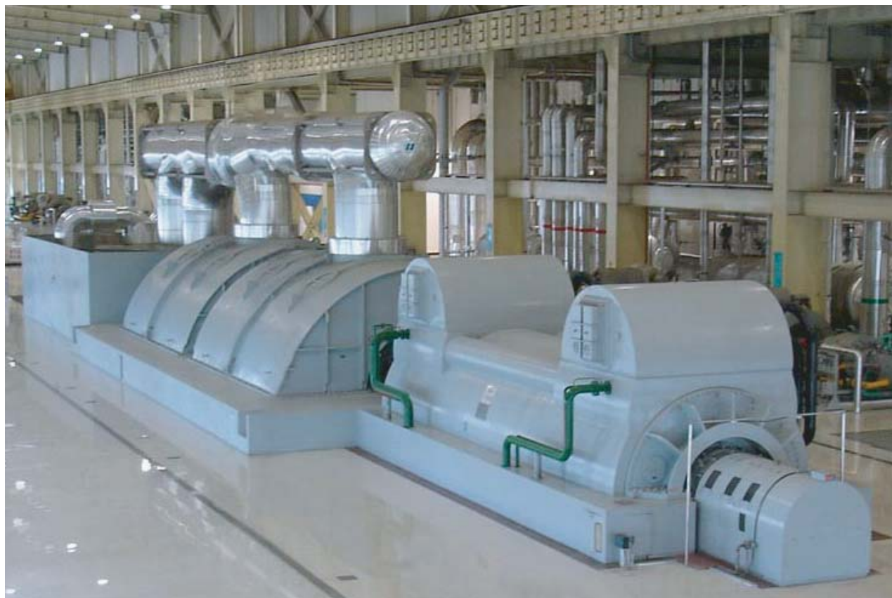
7号机组STG外观
