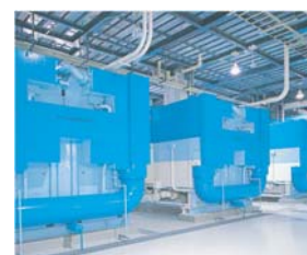
2500RT蒸气型吸收式冷水机组
